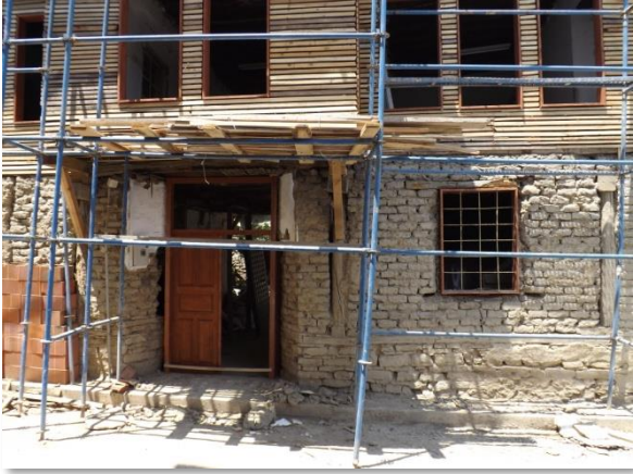
Fotoğraf 8. Değirmen Sokak düşey taşıyıcı ahşaplar (kişisel arşiv, 2015)
