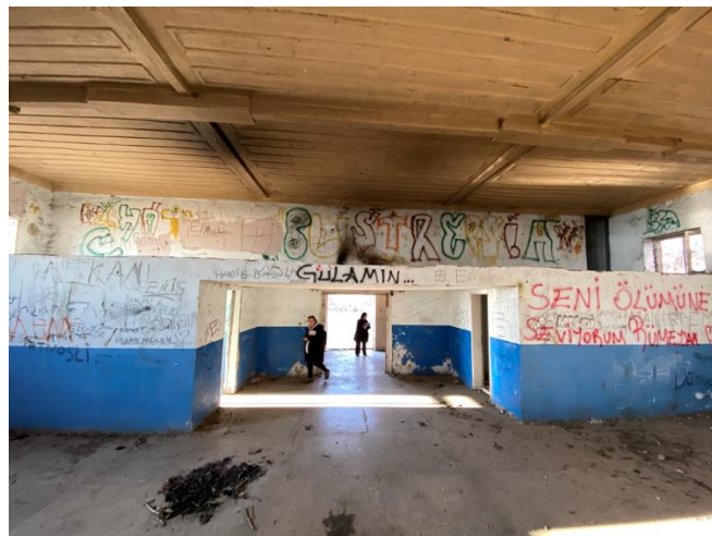
Şekil 9. Yerleşkedeki Yapıların İçlerinin Kötü Kullanımı Sonucu Oluşan Tahrifatlar
