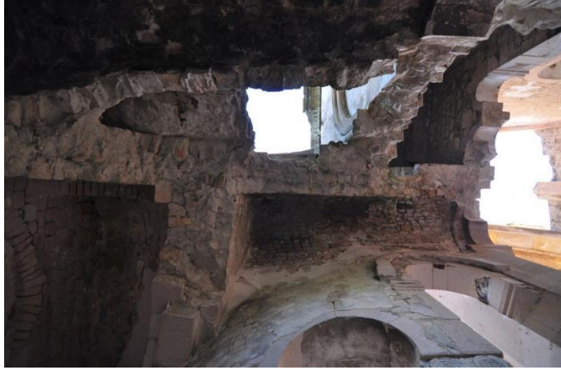
Görsel 21. Işhan Kilisesi, yıkılmış kuzey pastoforion odası, yıkılmış üst bölüm.
