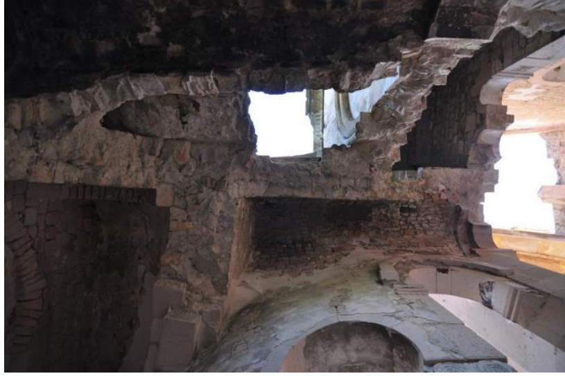
Görsel 21. İřhan Kilisesi, yıkılmış kuzey pastoforion odası, yıkılmış üst bölüm.
